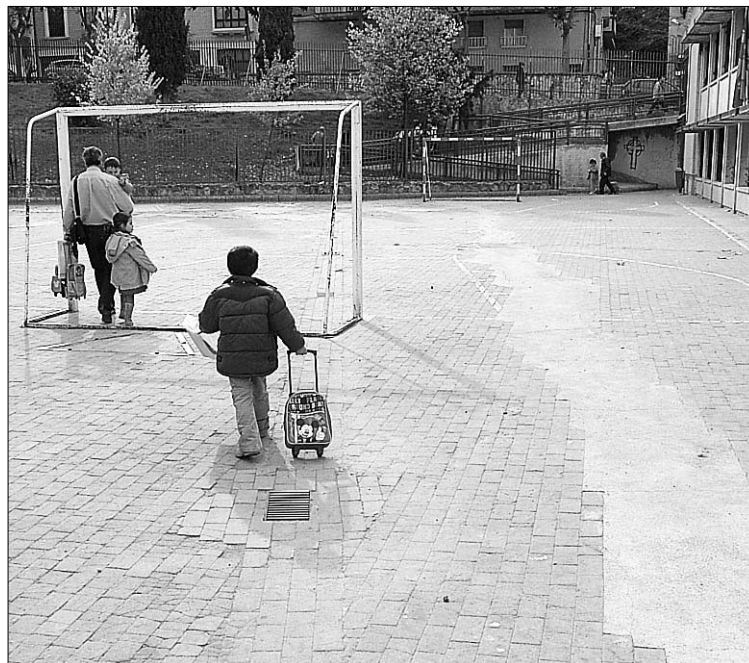
Estado del pavimento del patio escolar del "Fray Juan de la Cruz". JUAN MARTIN
