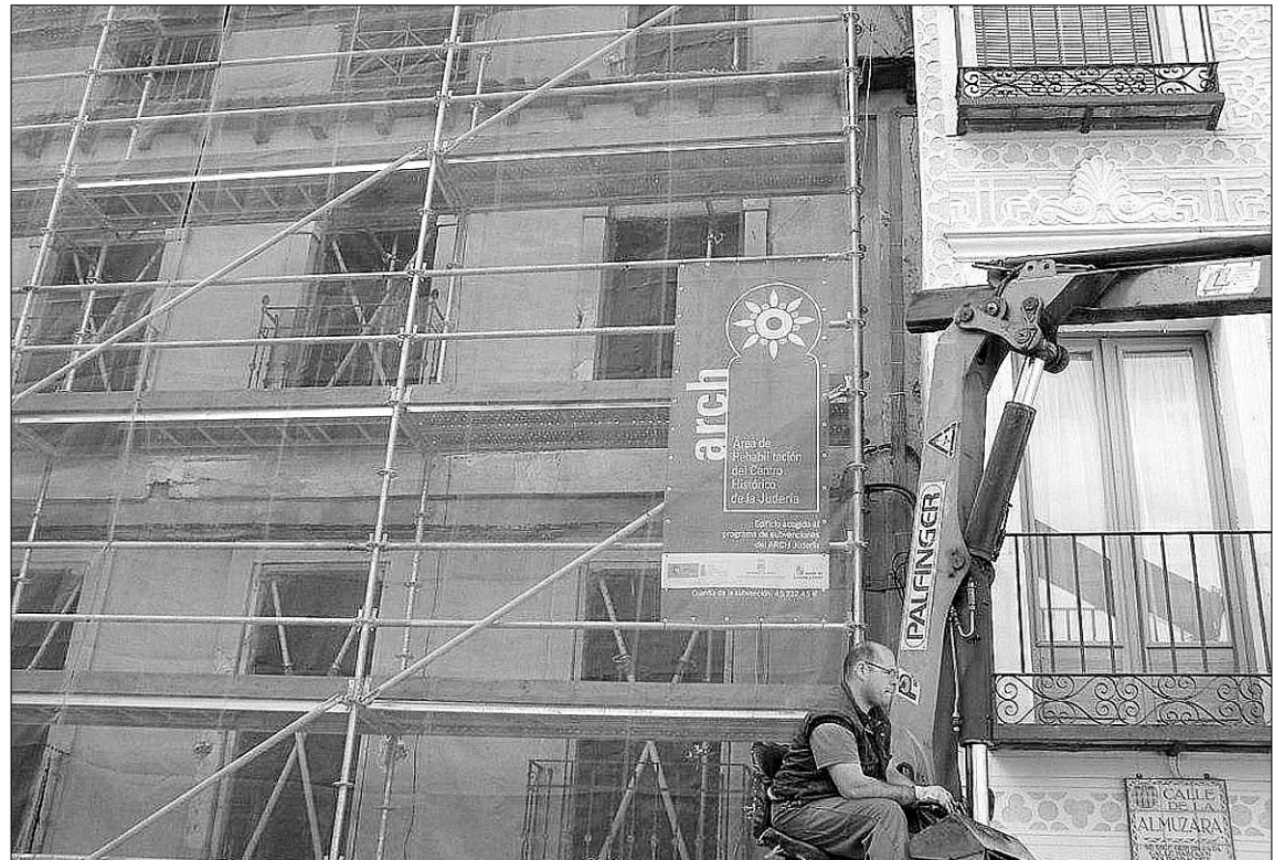
En la imagen, una de las viviendas que se ha beneficiado de las subvenciones del ARCH de la Judería de Segovia./ E.A.
