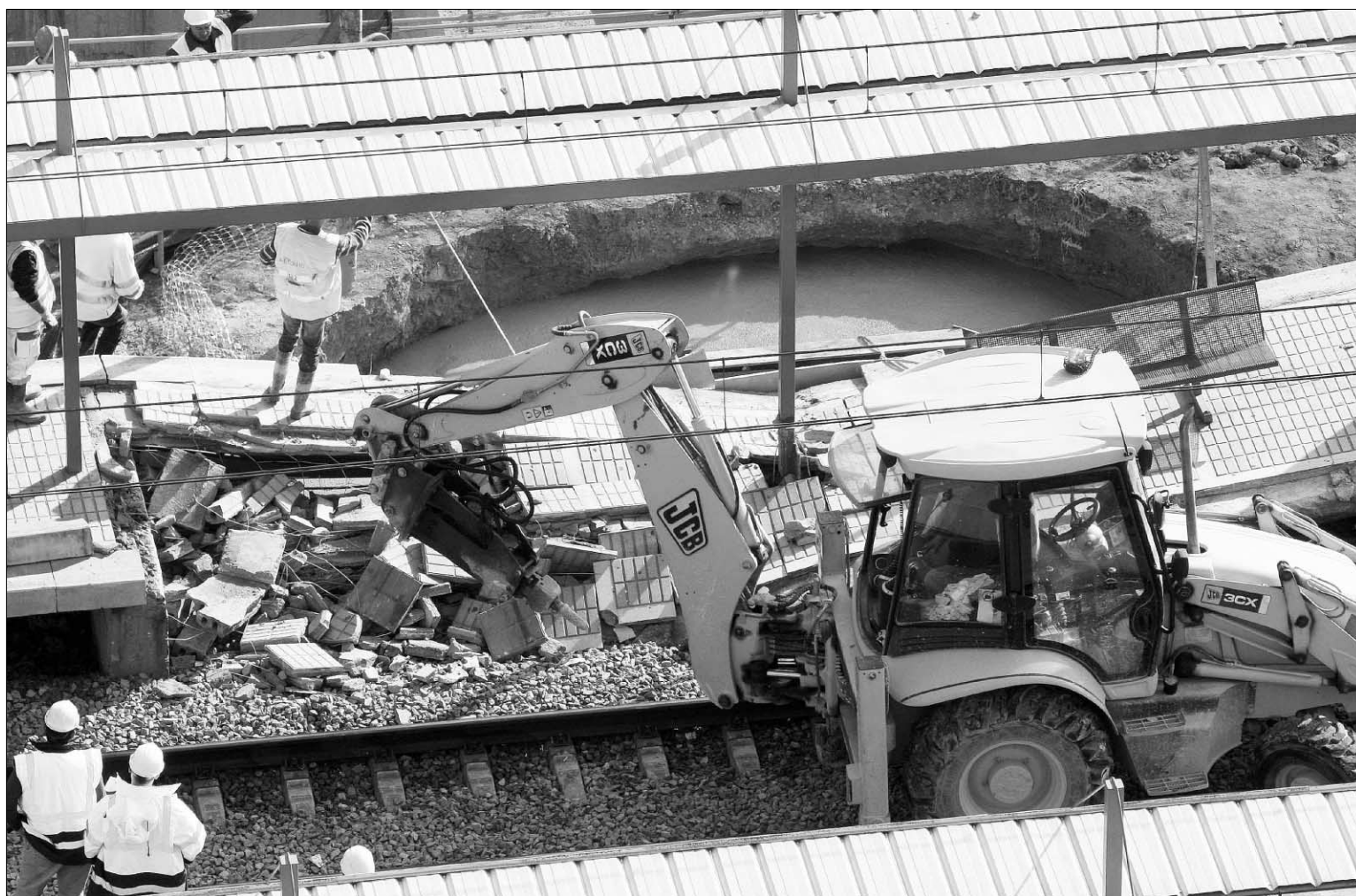
Varios operarios intentan neutralizar el hundimiento que las obras del tren de alta velocidad causaron ayer en la estación de Bellvitge. / EFE
