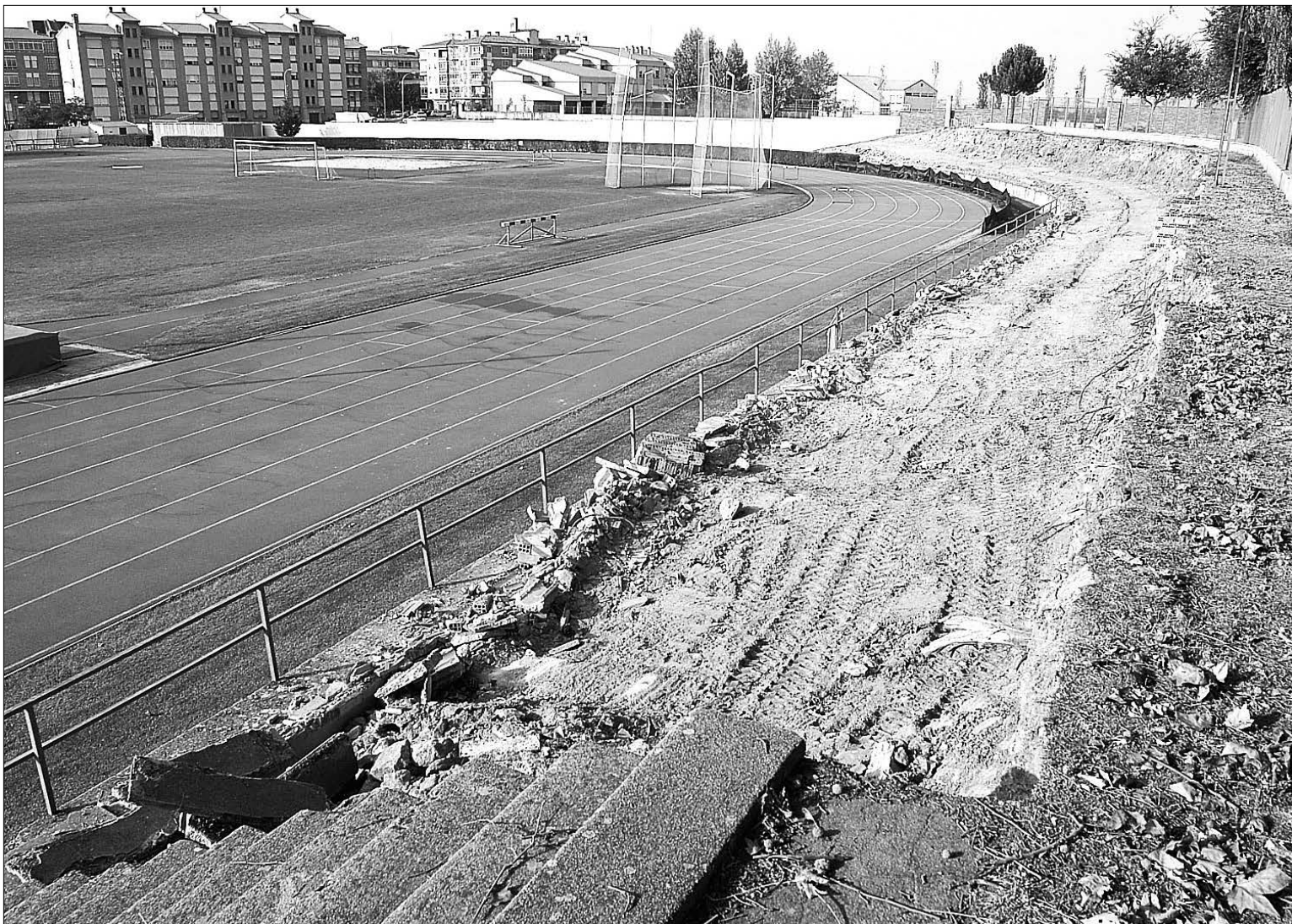
Situación de las obras en una parte de la grada descubierta de las pistas Antonio Prieto, en la Ciudad Deportiva de La Albuera. / JUAN MARTÍN
