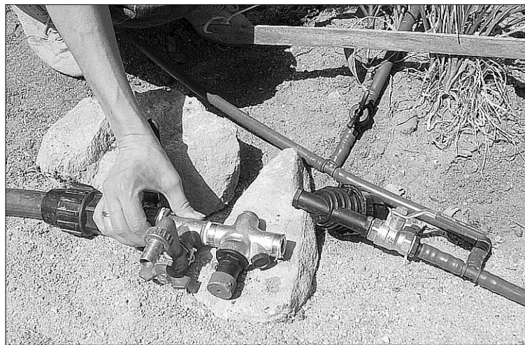
Destrozo realizado por los vándalos en una conducción de agua. / KAMARERO
