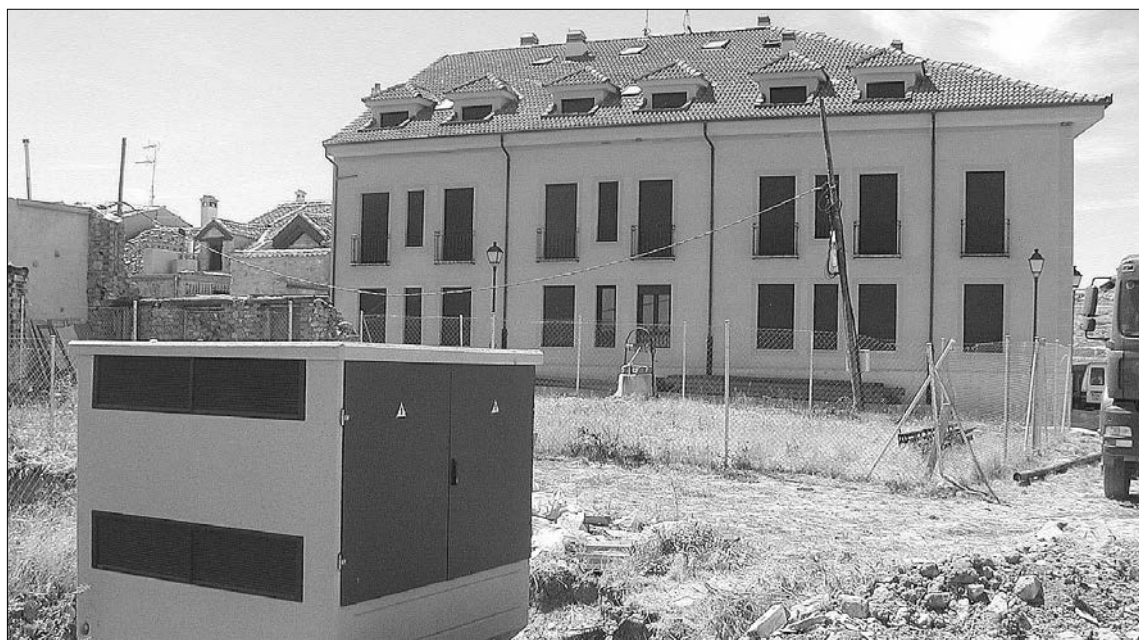
El transformador, instalado desde diciembre, aún no tiene el enganche necesario y los tubos se amontonan en la acera. // J. L. G.
