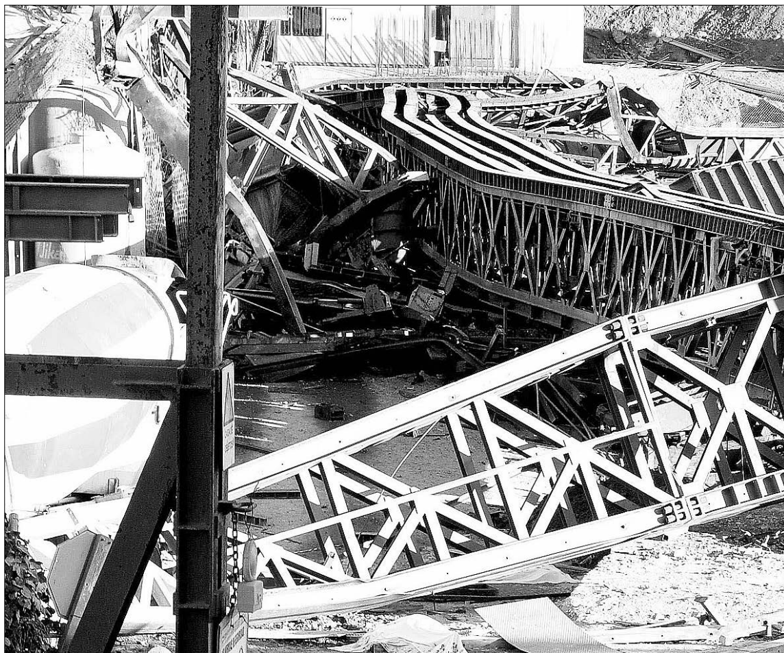
En 2005, el derribo de una plataforma de un viaducto a más de 80 metros se cobró varias vidas en Granada. / EFE
