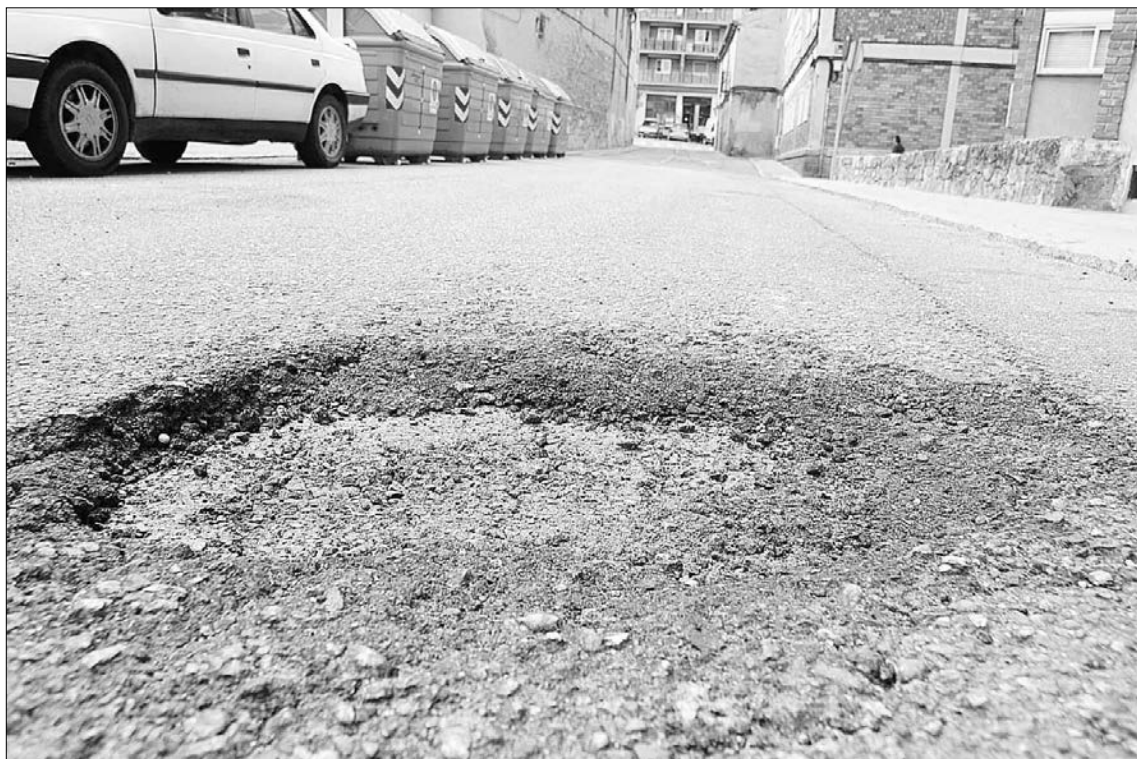
Algunos desperfectos en las calles o plazas pueden pasar desapercibidos para el resto de los ciudadanos. / KAMARERO
