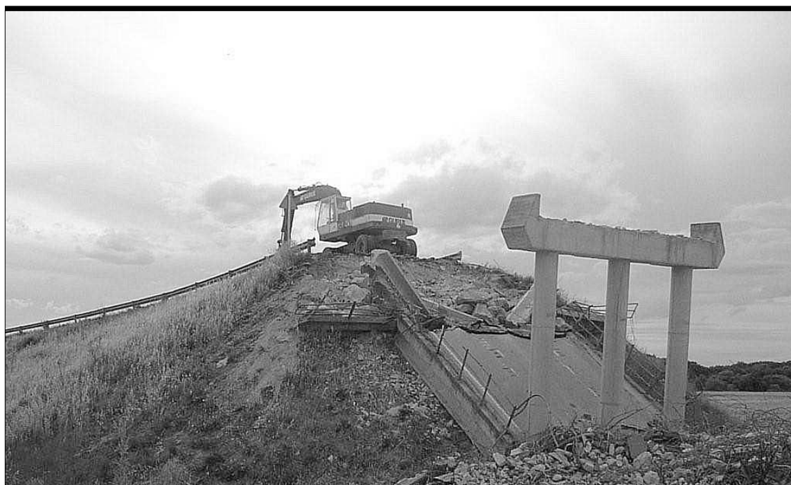
Desmante del puente de Hontanares. La empresa Hergonsa está realizando el derribo del puente elevado sobre la antigua vía férrea, unas obras incluidas en el Plan de Carreteras de la Diputación Provincial que están incluidas entre las mejoras que lleva la empresa a lo largo de cinco kilómetros y que incluirá la construcción de un nuevo puente sobre el río Eresma y varias mejoras viales más. / FOTO: ÁLVARO PINELA
