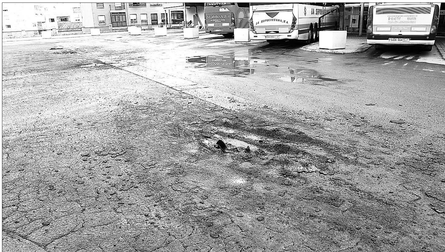
Las lluvias han puesto en evidencia el deterioro que sufre el pavimento de la zona central de la explanada de la estación de autobuses//JUAN MARTÍN
