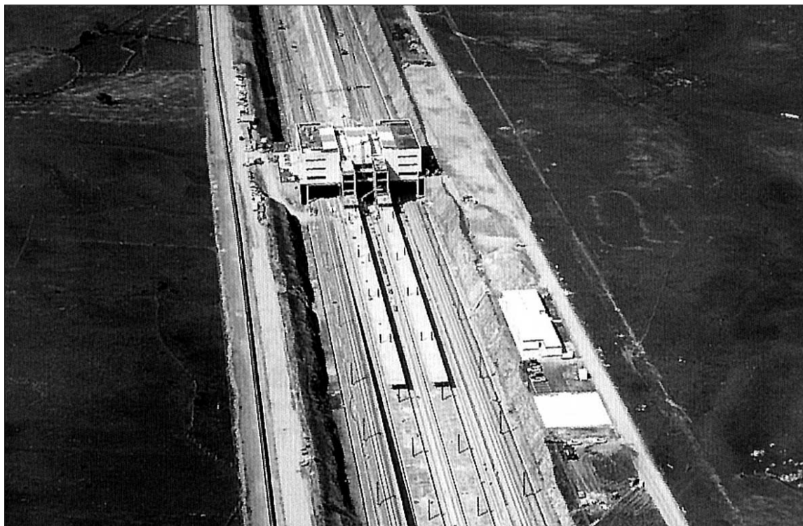
Vista aérea de la nueva estación del AVE de Segovia, que se encuentra a un 90% de ejecución/EL ADELANTADO
