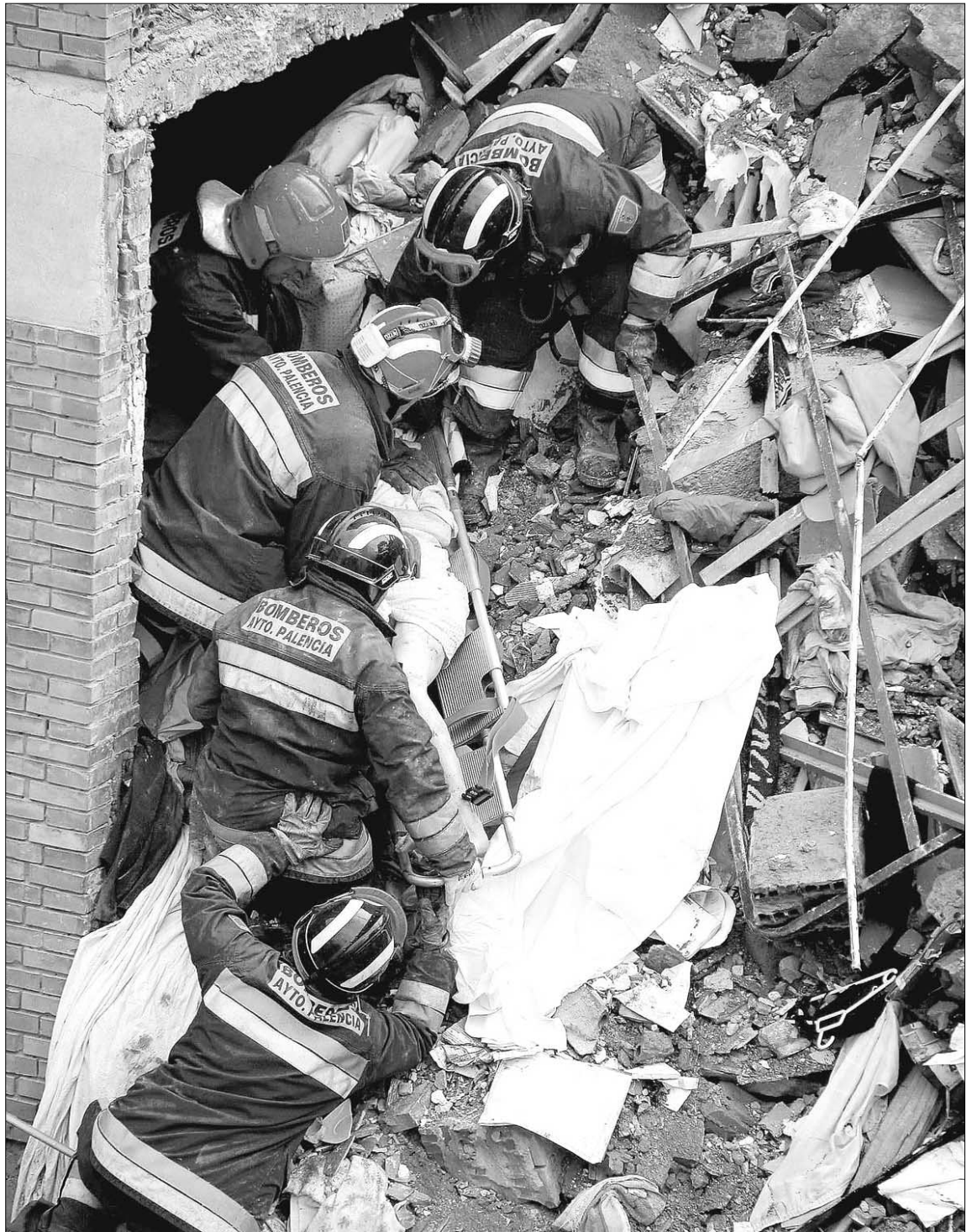
Los bomberos rescatan el cuerpo de una mujer fallecida en el derrumbe del edificio de Palencia. / RICARDO ORDÓÑEZ (ICAL)
