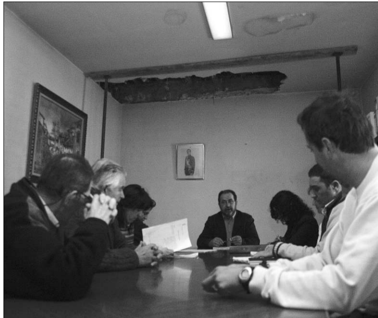
Estado que presenta el techo del salón de plenos. /GABRIEL GÓMEZ
