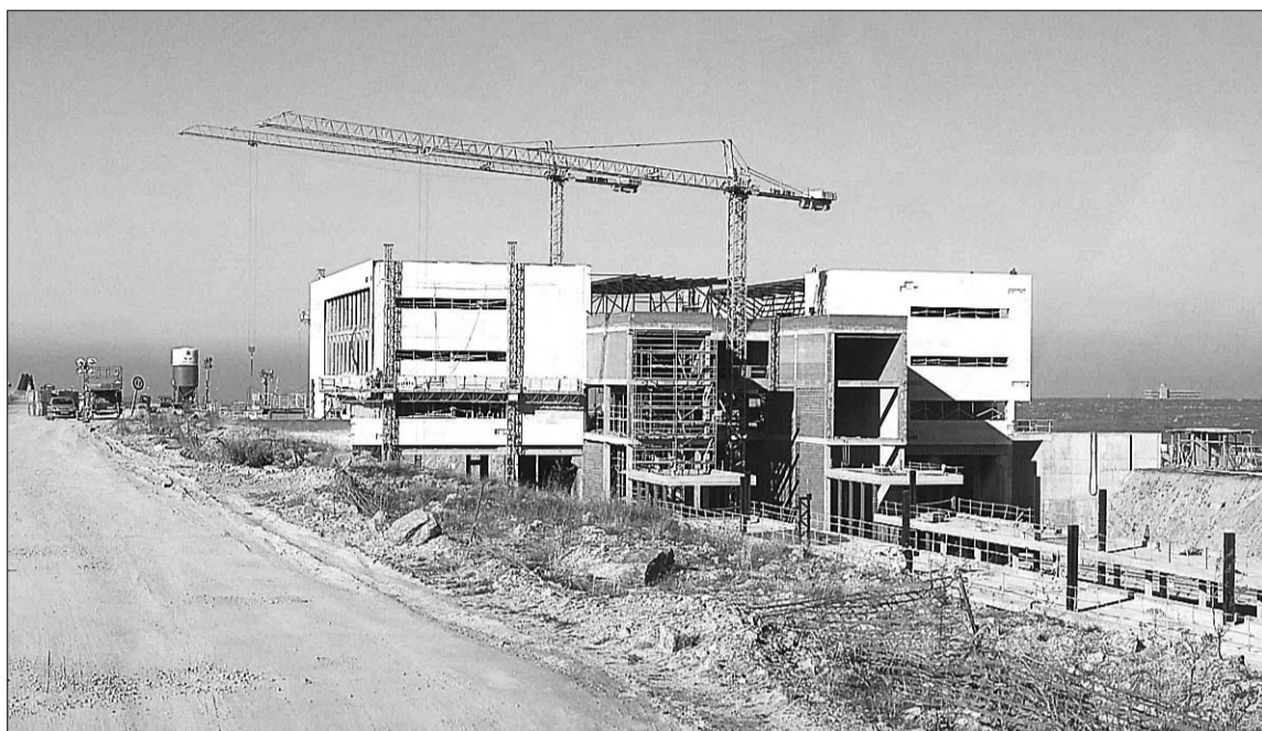
Mientras avanzan las obras de construcción en la estación del AVE se abren nuevas expectativas para su entorno. / PEÑALOSA
