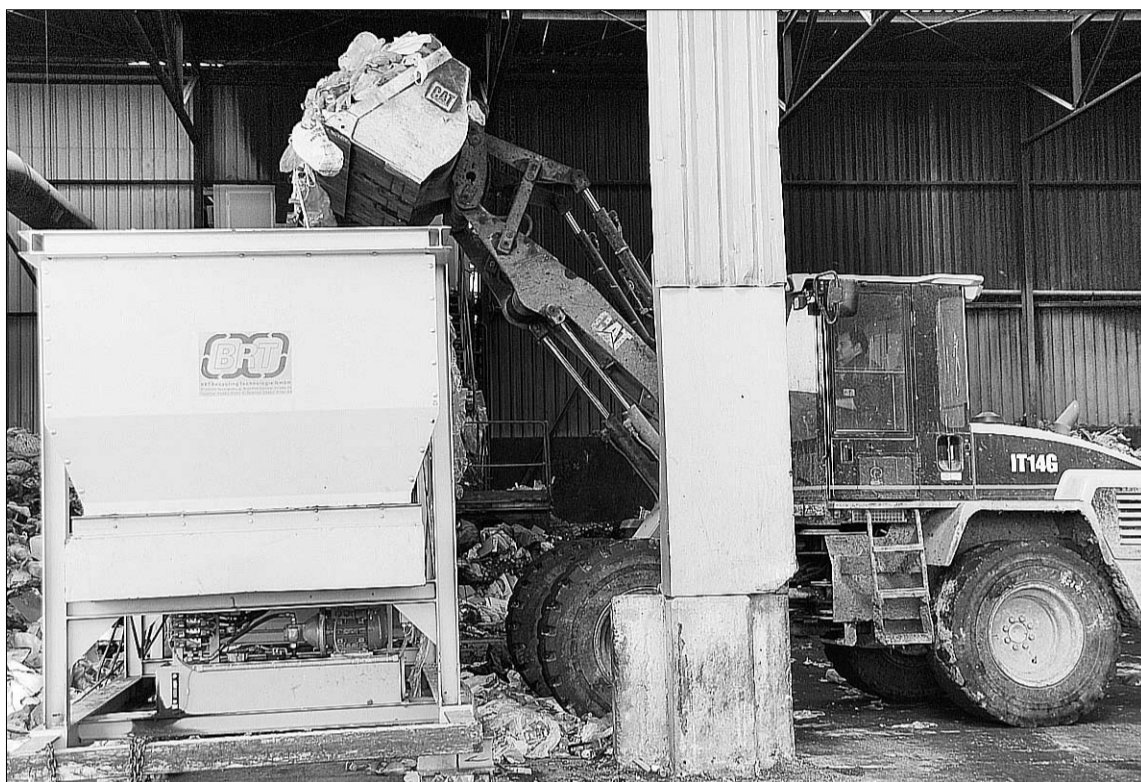
La planta de tratamiento de residuos de Los Huertos fue construida en 1999 y está pendiente de su ampliación./KAMARERO
