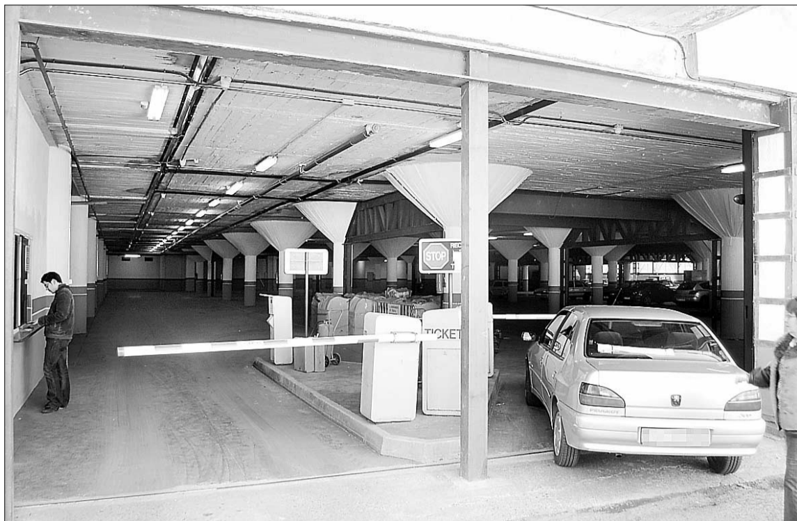
El aparcamiento de la estación municipal cuenta ahora con 154 plazas, 26 más que antes de su remodelación/KAMARERO
