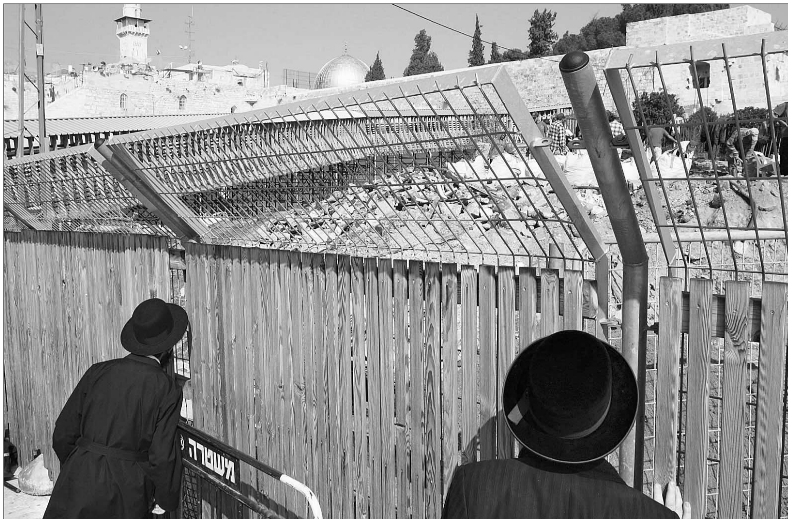
Varios ultraortodoxos observan las obras que lleva a cabo Israel en la Explanada de las Mezquitas. / ODED BALILTY (AP)
