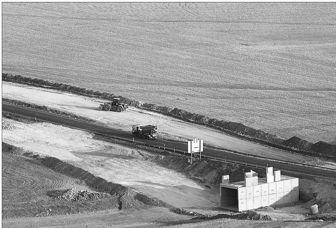
Vista parcial de las obras de construcción de la futura autovía Segovia-Valladolid. / JUAN MARTÍN
