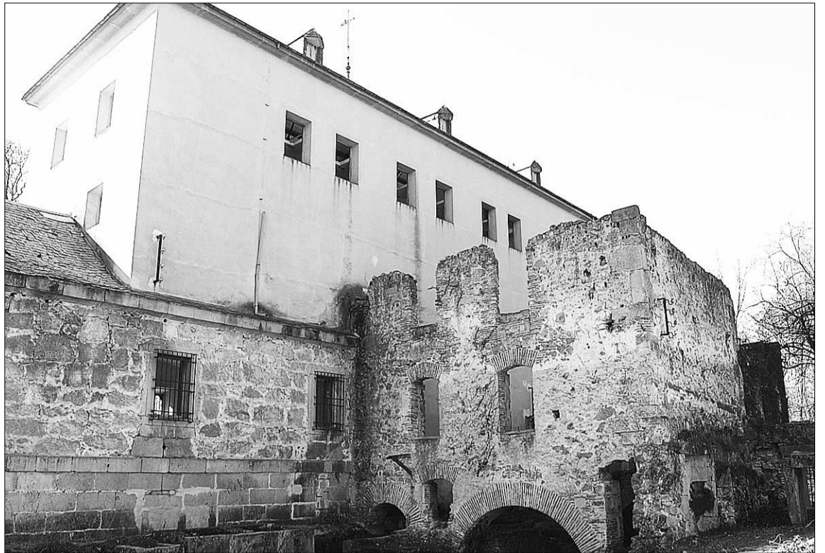
Las obras de rehabilitación de la Casa de la Moneda se prolongarán durante 24 meses./FERNANDO PEÑALOSA
