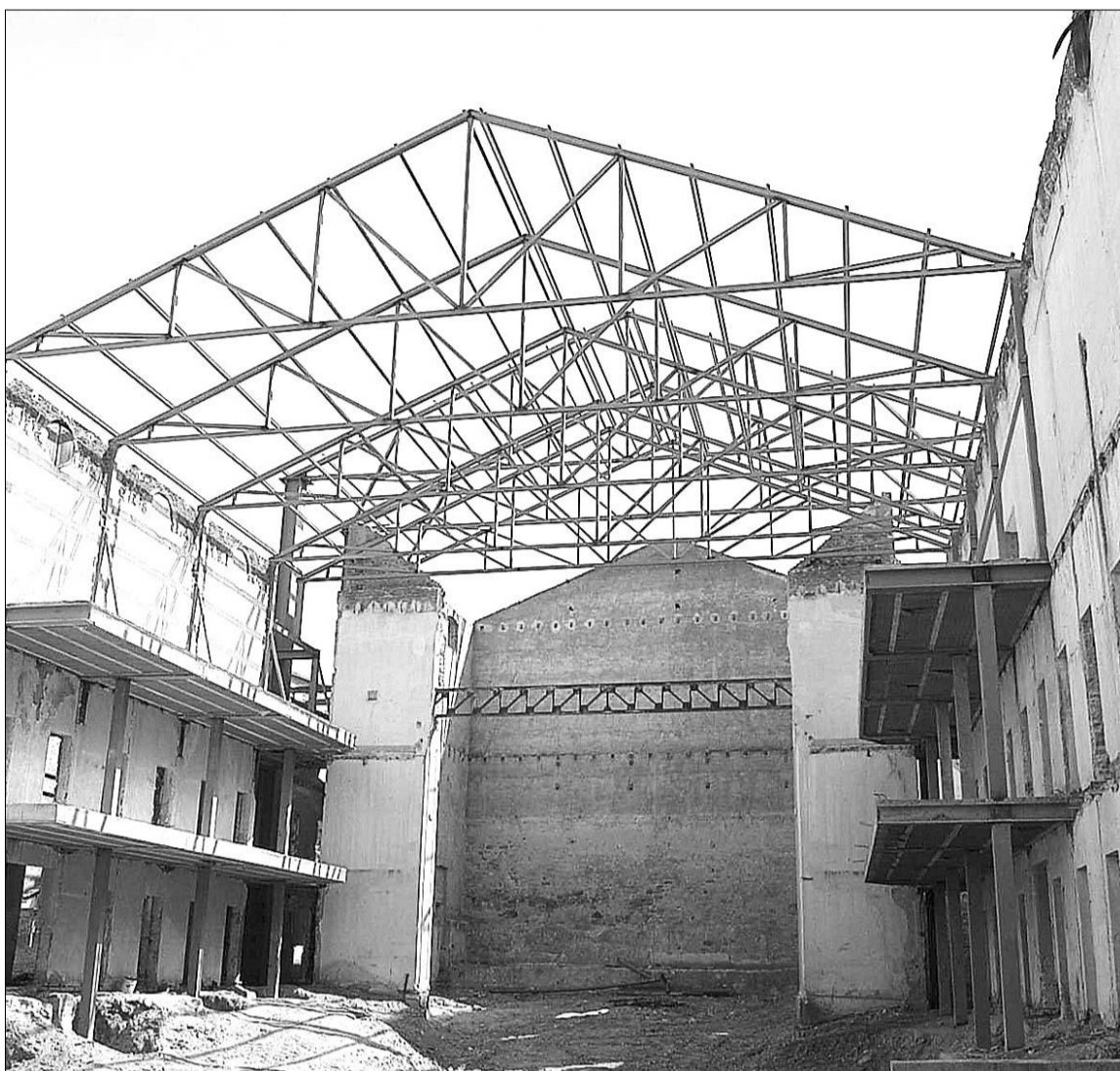
Las obras de rehabilitación del Teatro Cervantes llevan paralizadas desde marzo de 2006 por orden de la Junta. / JUAN MARTÍN
