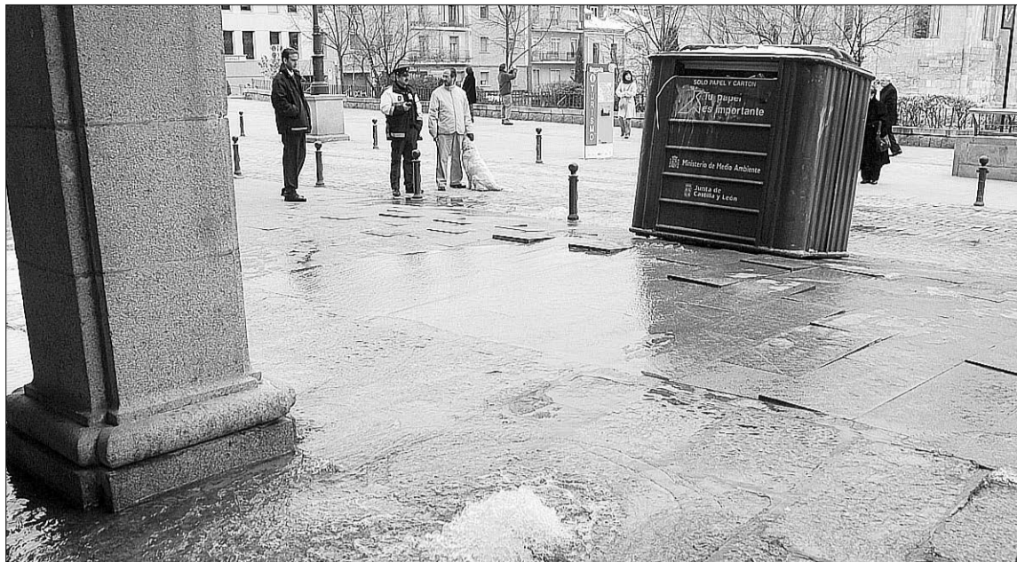
La rotura provocó el levantamiento de las losas de la avenida en una superficie de unos 12 metros cuadrados./KAMARERO
