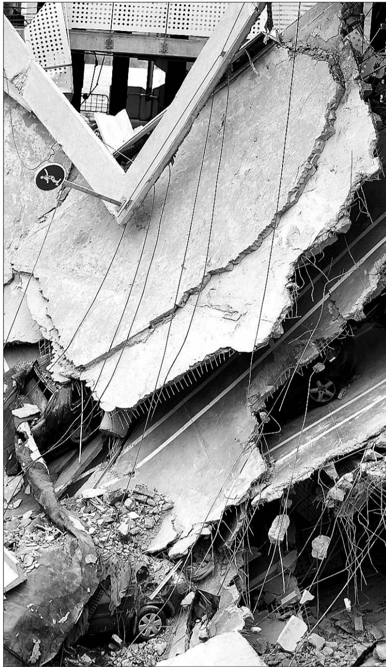
Bajo los escombros de la T-4 quedan todavía decenas de vehículos. / EFE
