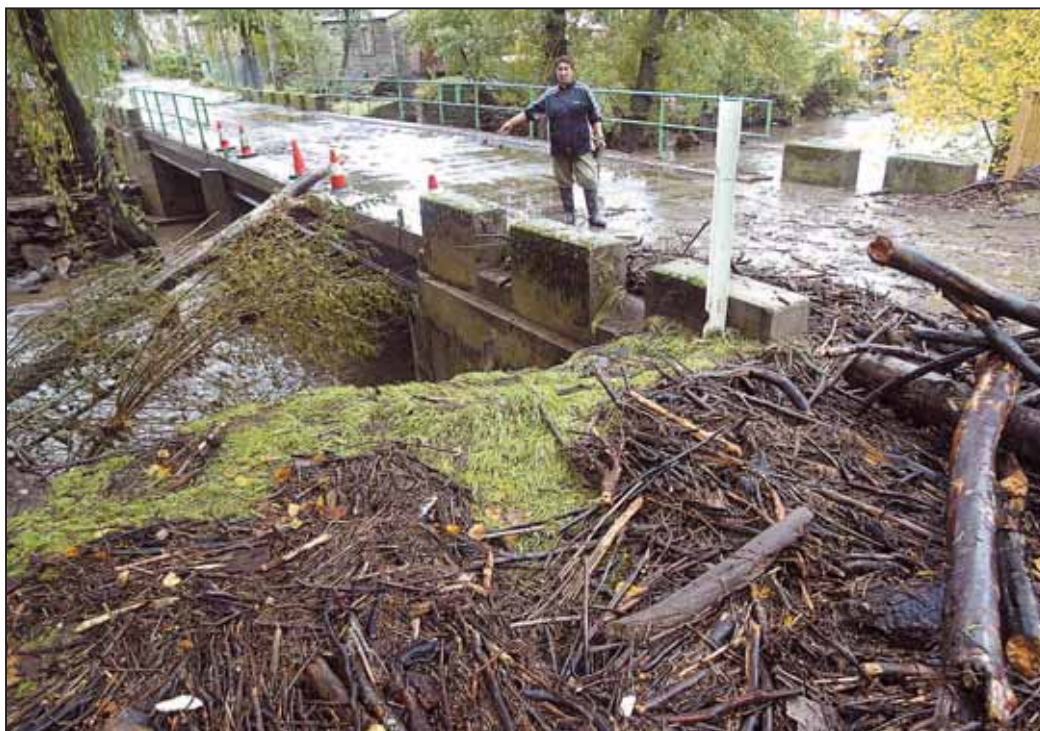
Una vecina de Rihonor de Castilla (Zamora) señala la parte del puente arrancada por el agua. /ICAL
