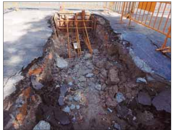
La rotura del colector provocó graves daños en la calzada de Vía Roma /F.P.
