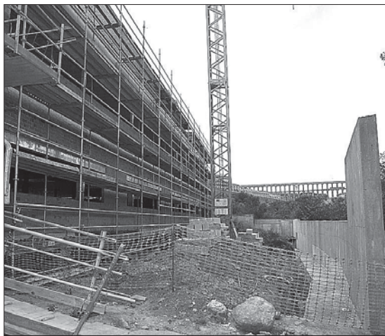
El primer edificio albergará las consultas y el centro de guardias./JUAN MARTIN
