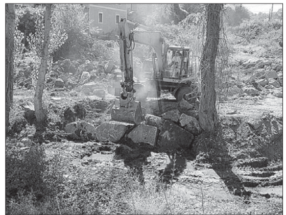
Vista parcial de las obras que se están realizando en el Eresma. / PEÑALOSA
