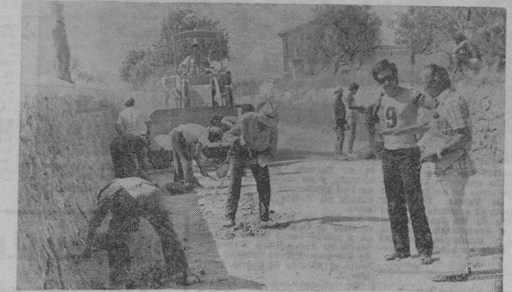
EL CONTRATISTA DON BARTOLOME RAMON EXPLICA A NUESTRO REDACTOR LA RAPIDA FORMA DE TRABAJAR DE LAS EXCAVADORAS Y DE LAS APISONADORAS, COMO PUEDE VERSE EN LA FOTO TOMADA AYER, LA ZANJA YA ESTABA CUBIERTA.
