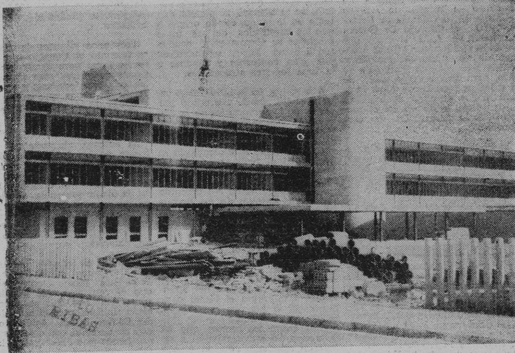
VISTA DEL ESTADO DE LAS OBRAS EN LA QUE PUEDE VERSE LO AVANZADO DE LAS MISMAS.
