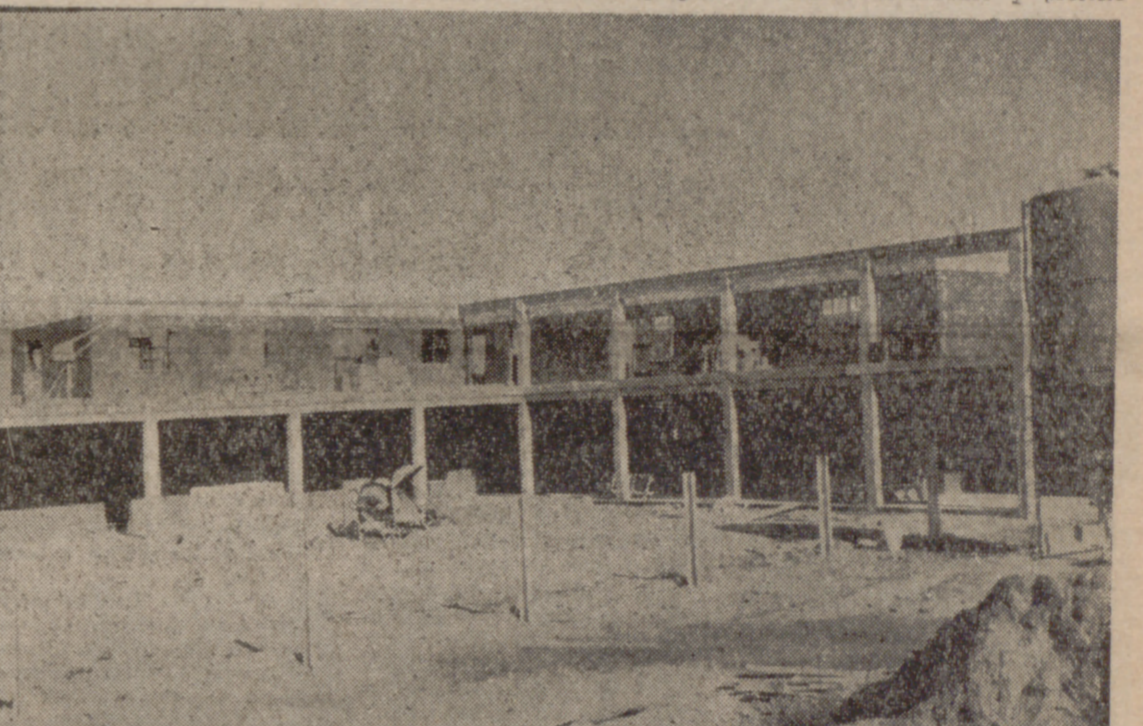
Las obras del mercado de ganados van adelantadísimas y se prevé que antes de fin de año estén ya dispuestas para entrar en servicio.
