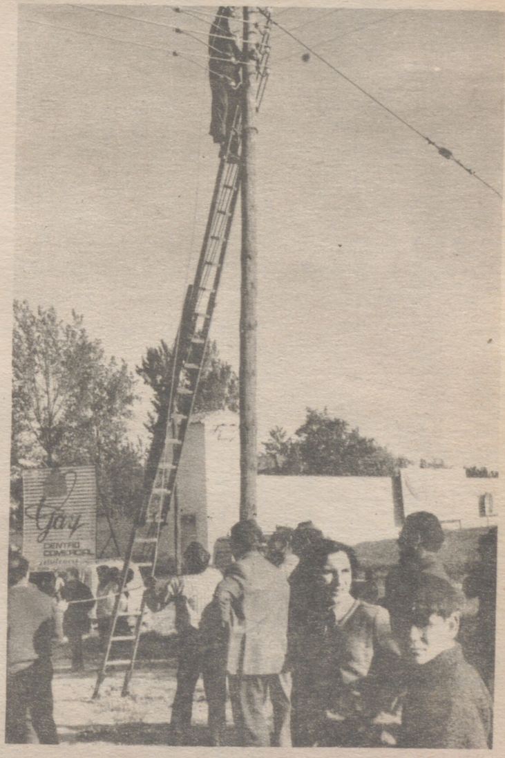
"Electricas Reunidas" también tuvo que estar allí para cortar la luz. Al fondo está la blanca tapia que nos esconde el agua de emergencia que de la piscina tuvieron que tomar los bomberos. Quinientos mil litros de agua hablan con elocuencia de lo que el siniestro fue.
