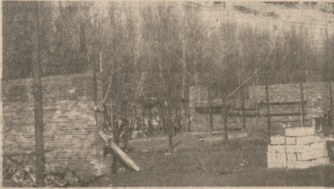
En la pradera, junto a la playa y en el mismo lugar donde estuvo enclavado el bar, se construye en la actualidad un local de dos pisos en el que serán instalados un restaurante con terraza, una barra al aire libre y una sala de té. En la fotografía, un aspecto de estas obras, que a juicio de su propietario estarán terminadas aproximadamente para Semana Santa.
