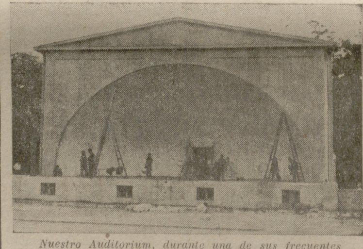
Nuestro Auditorium, durante una de sus frecuentes reparaciones.
