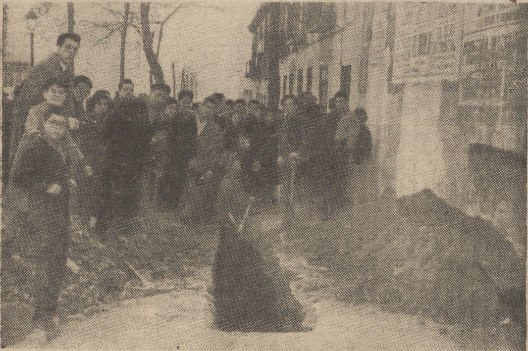
Durante toda la mañana de ayer y parte de la tarde, las brigadas de obreros trabajaron incansablemente para localizar el escape de gas que produjo la muerte de una mujer, y en el que resultaron intoxicados ocho vecinos más de la finca sita en el número 104 de la calle de Embajadores. En la fotografía, nuestro redactor gráfico Mamegam ha captado un momento de estos trabajos, que fueron presenciados por numeroso público, ávido de conocer los pormenores del triste suceso.
