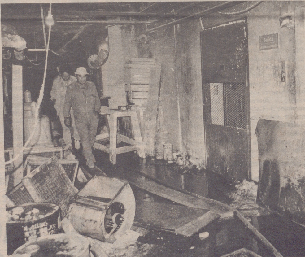
La sala de calderas, del sótano cuarto, donde se produjo el accidente, momentos después de la explosión.
