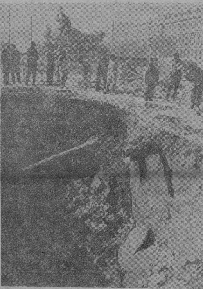
Grandes llamaradas surgieron junto a la estatua de la Cibele de Madrid durante la noche del día 3. Una avería en las conducciones de agua produjo el desmoronamiento del terreno, la rotura de las conducciones de gas y un incendio que salió a la superficie a través del socavón abierto. En la foto, el «cráter» de la Cibele, 15 metros de diámetro y 10 de profundidad, junto a la famosa estatua. — (Fotofiel).
