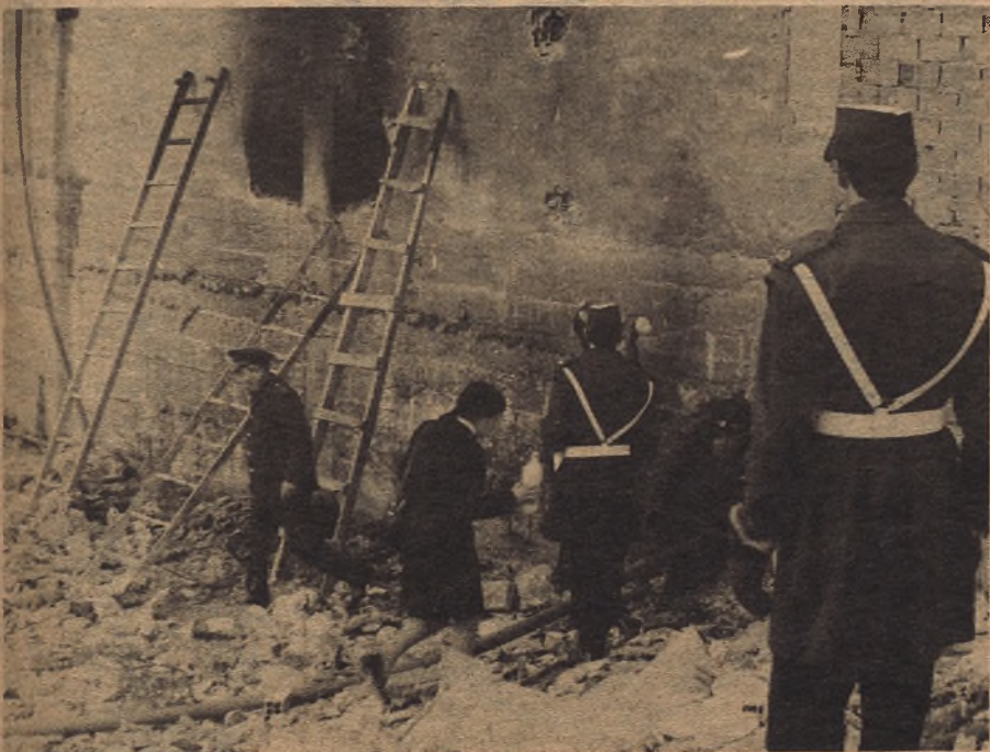
En la fotografía, uno de los boquetes que hubo que abrir en el costado del inmueble para poder iniciar las tareas de rescate.
