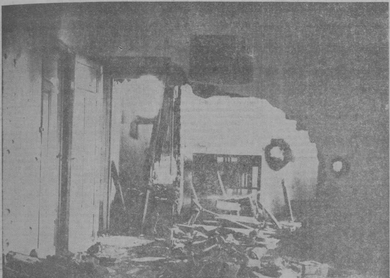
Interior de la vivienda de un guardia en el cuartel de Oviedo, después de bombardeado
