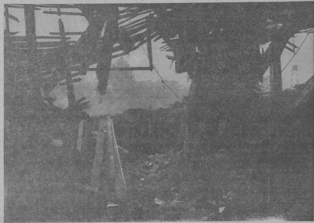
Planta alta del cuartel de Sama, en que se aprecian las cubiertas destruidas
