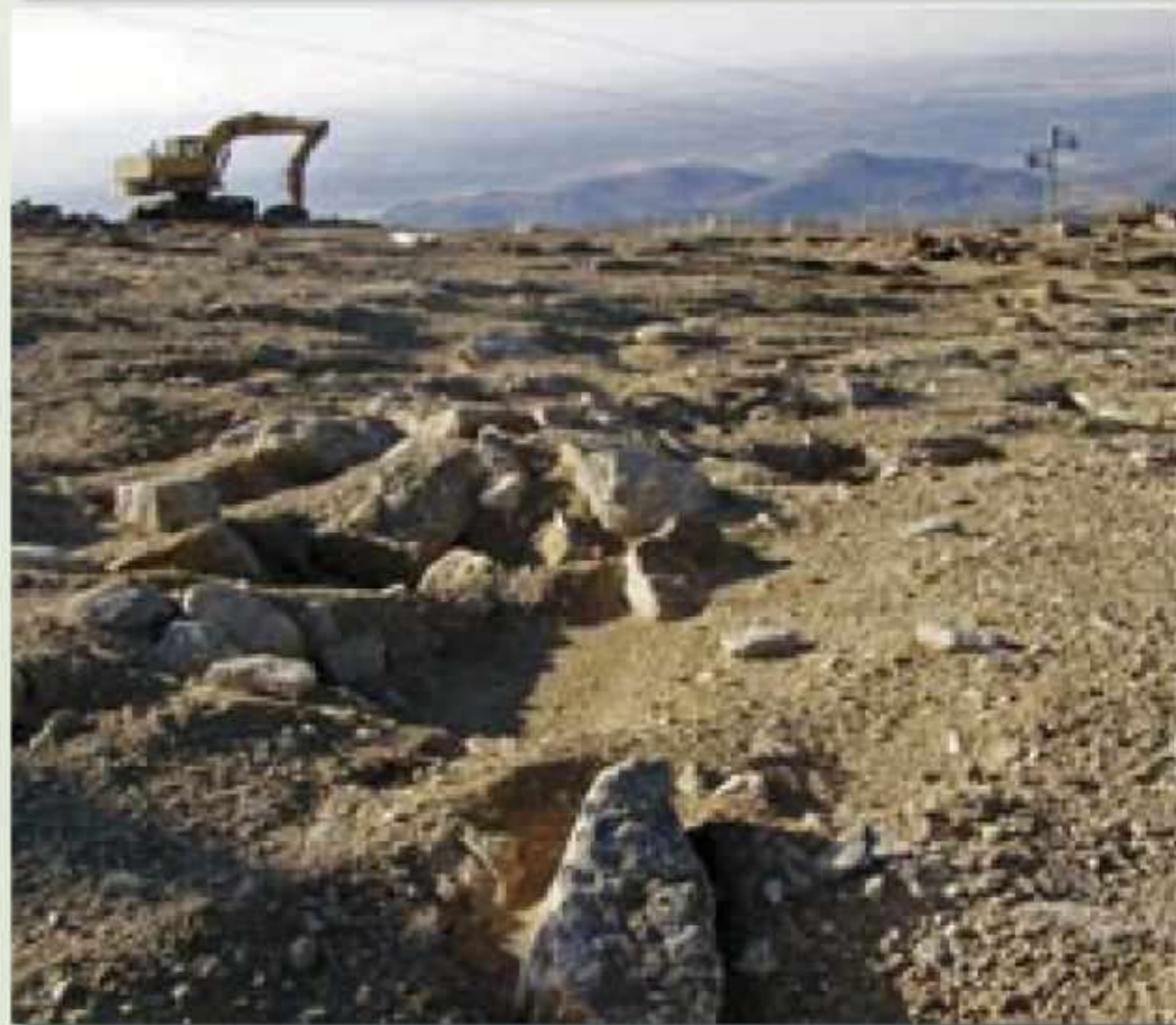
1, 3 y 4: diversos aspectos de las obras de ampliación de las instalaciones para el esquí en La Covatilla.
