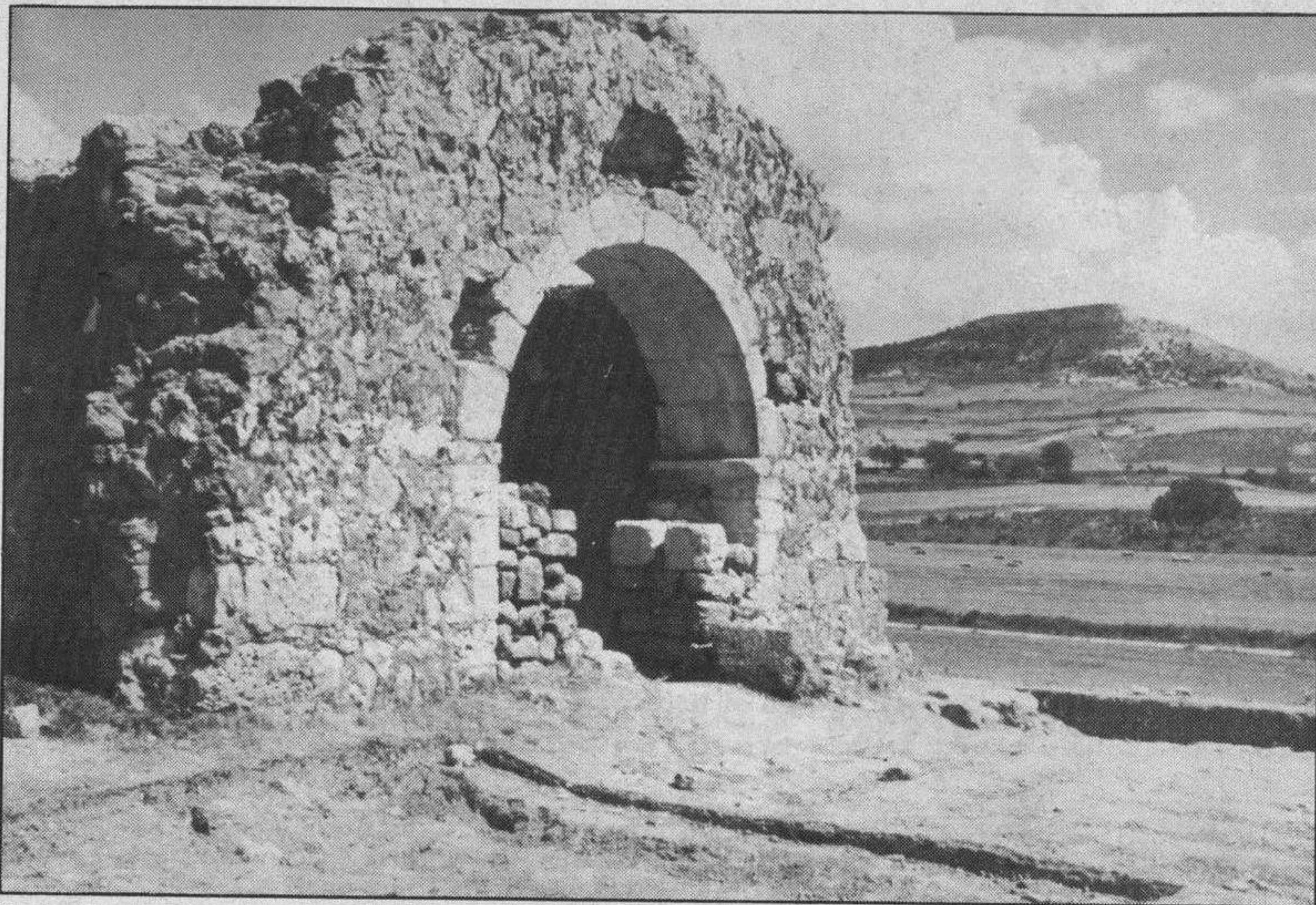
La ermita está esperando su restauración. (Foto: Lara).
