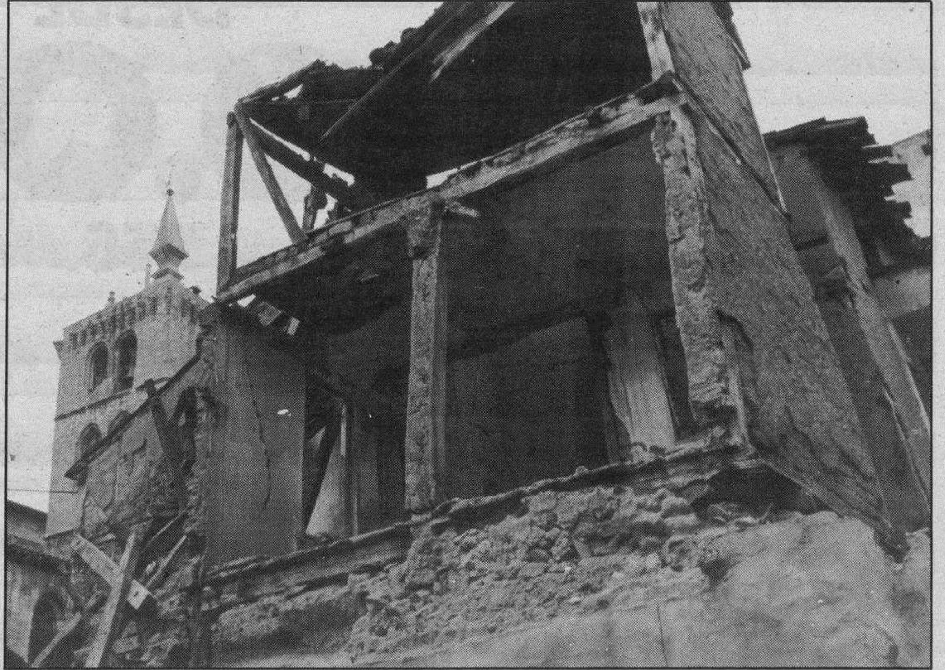
Los edificios en ruinas son un problema en gran parte del casco urbano.(Foto: Lara).
