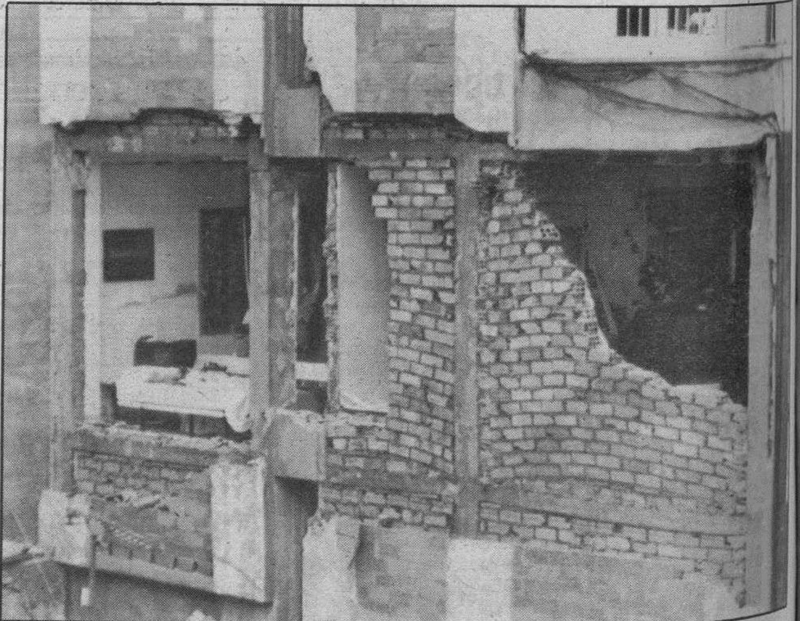
Este es el estado en que quedó un piso barcelonés de la calle Londres tras producirse una explosión de gas que dejó como saldo un herido leve y grandes daños materiales. Efe.
