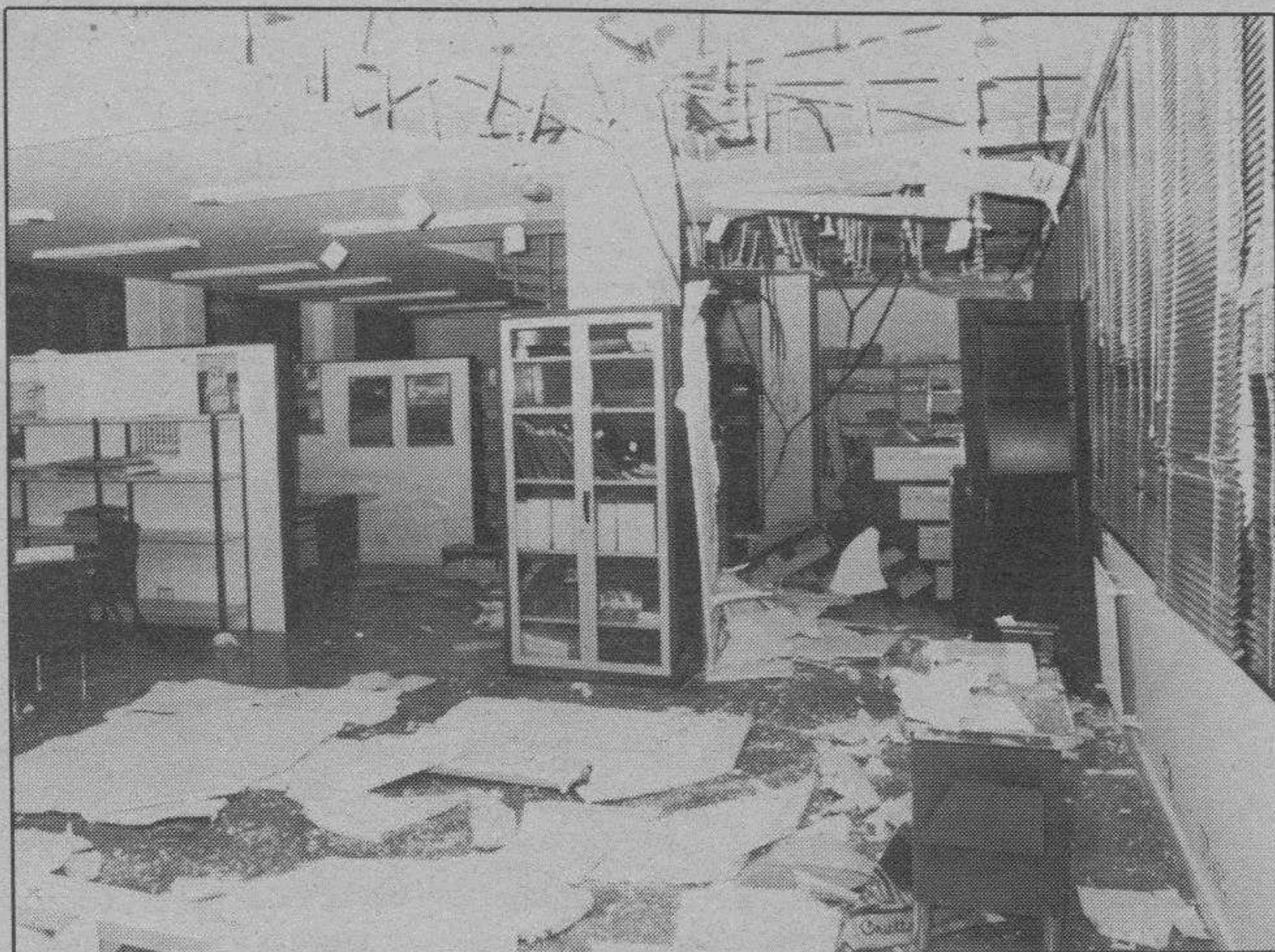
En funcionamiento los servicios del edificio de Usos Múltiples, pese a los destrozos sufridos.
