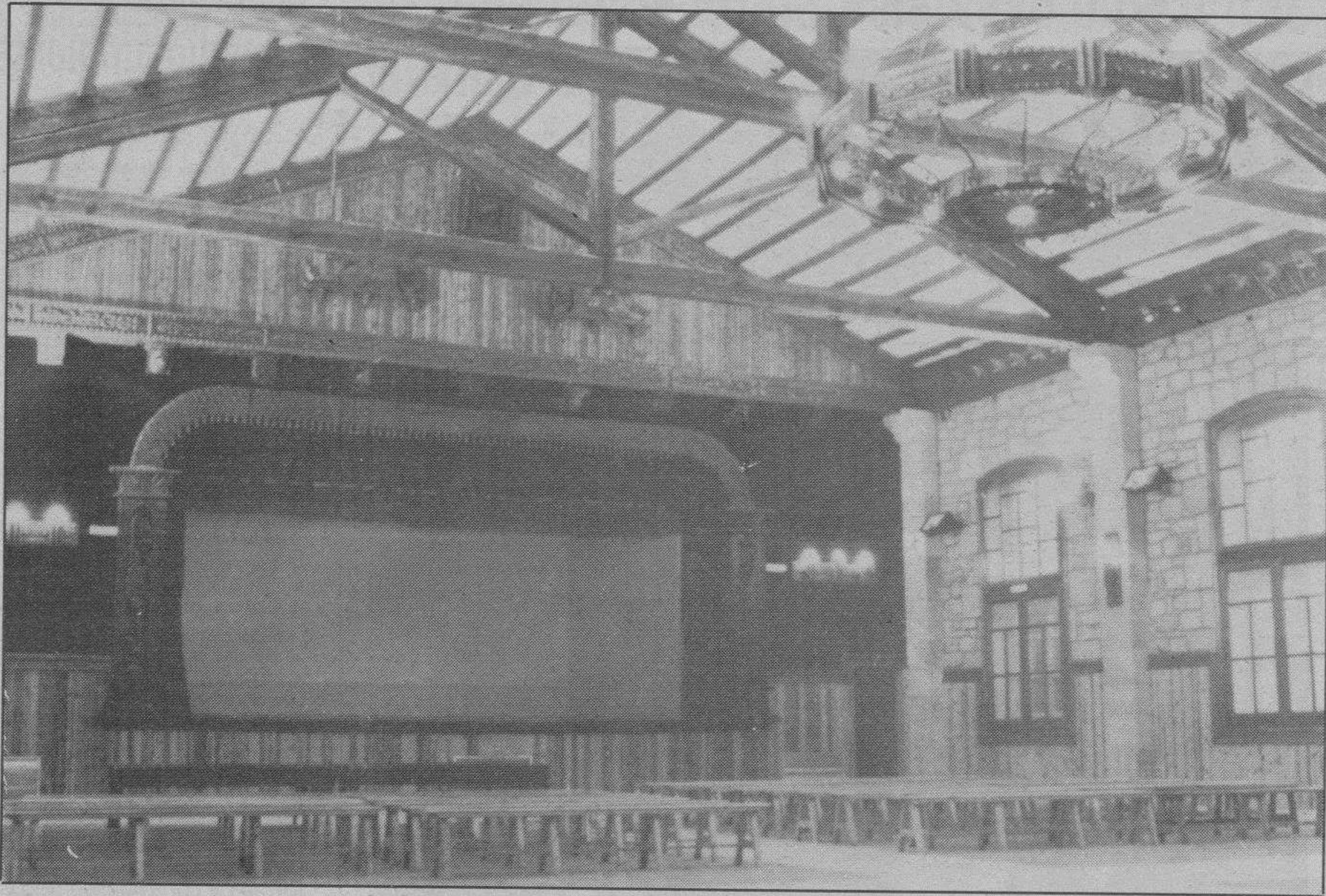
Salón municipal de Quintanar. La madera si está bien aislada del agua aguanta el paso de los años aunque sea en un tejado frecuentemente sobrecargado por numerosas nevadas.
