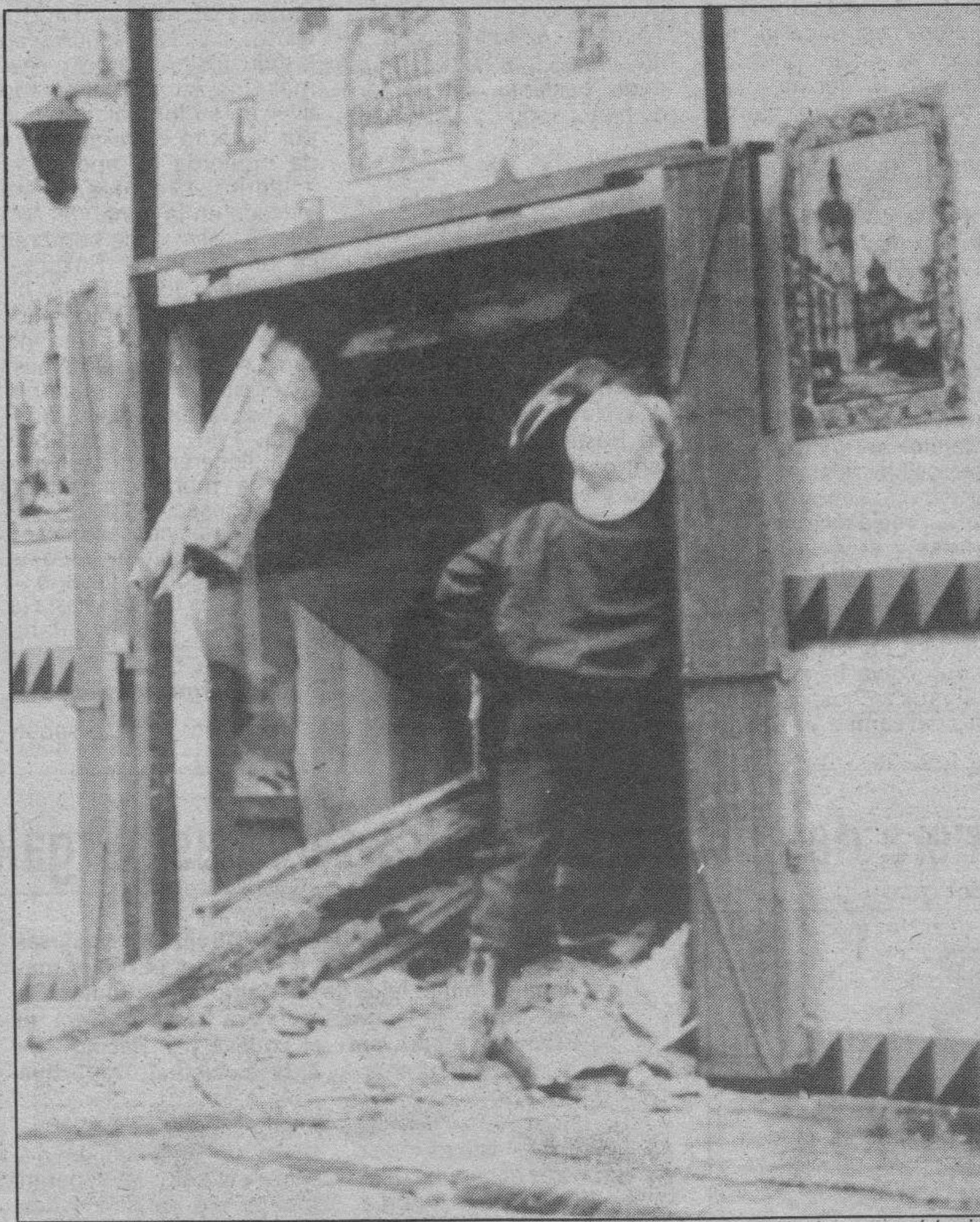
Una finca de la calle Bolsería de Valencia se hundió a consecuencia de las lluvias y causó heridas leves a tres personas. Efe
