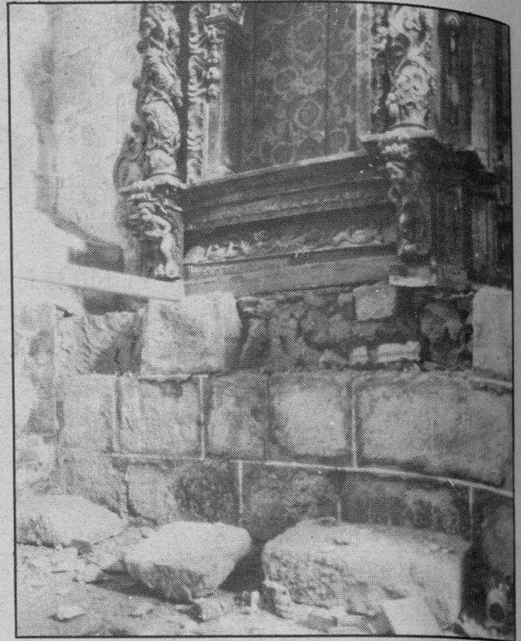
En el interior de la iglesia se desprendieron algunas piedras, como ocurrió junto a este retablo.
