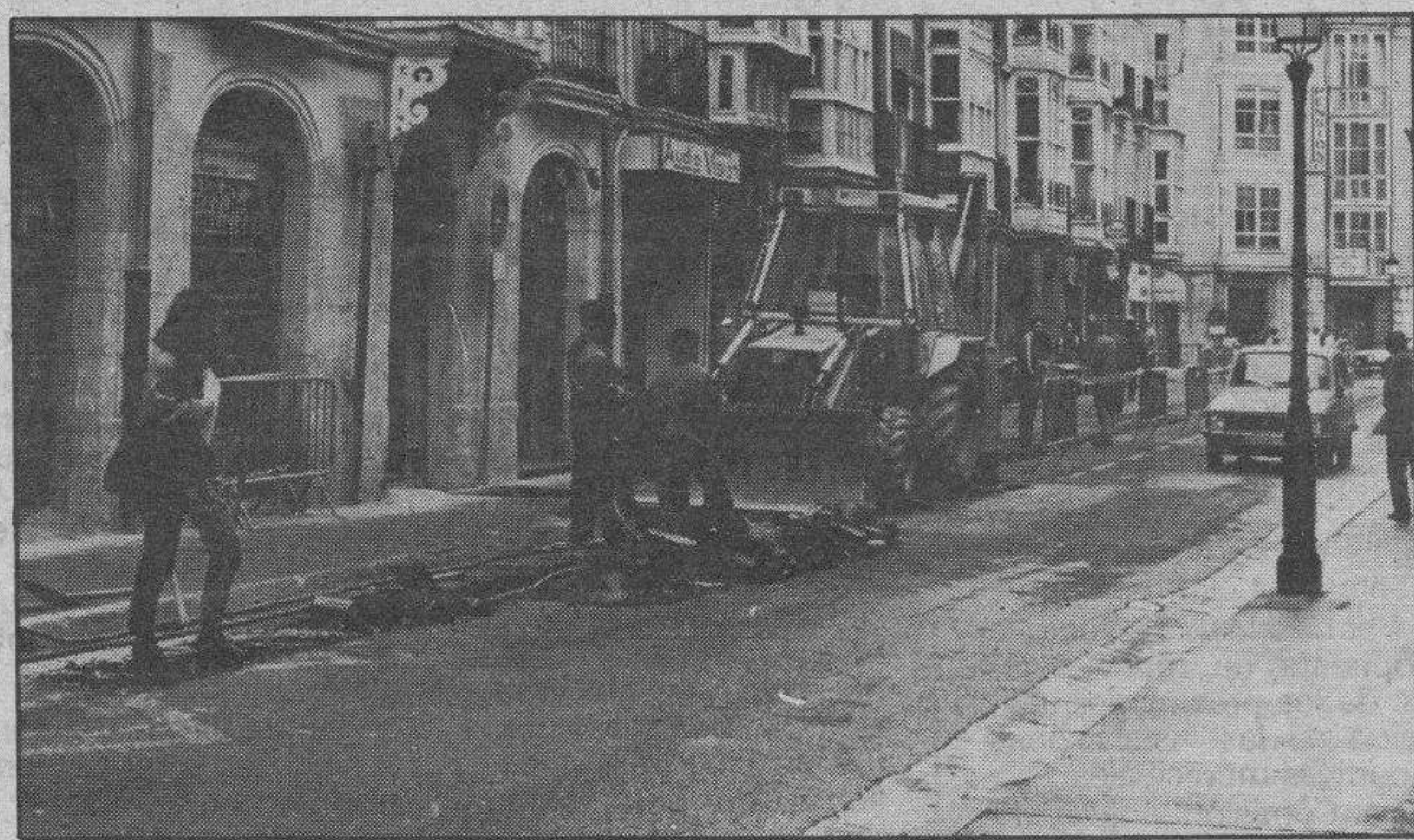
Obras para ampliar la conducción del gas natural. — Lain Calvo es otra de las vías públicas a las que se extiende progresivamente el programa de conducción de las tuberías de gas natural para usos domésticos y comerciales. Ayer el fotógrafo captó el instante de una de las obras que han obligado a cortar de forma intermitente el tráfico y a desviarlos por Avellanos, San Gil y Huerto del Rey. Las previsiones indican que esta situación durará hasta el próximo viernes, día 17.
