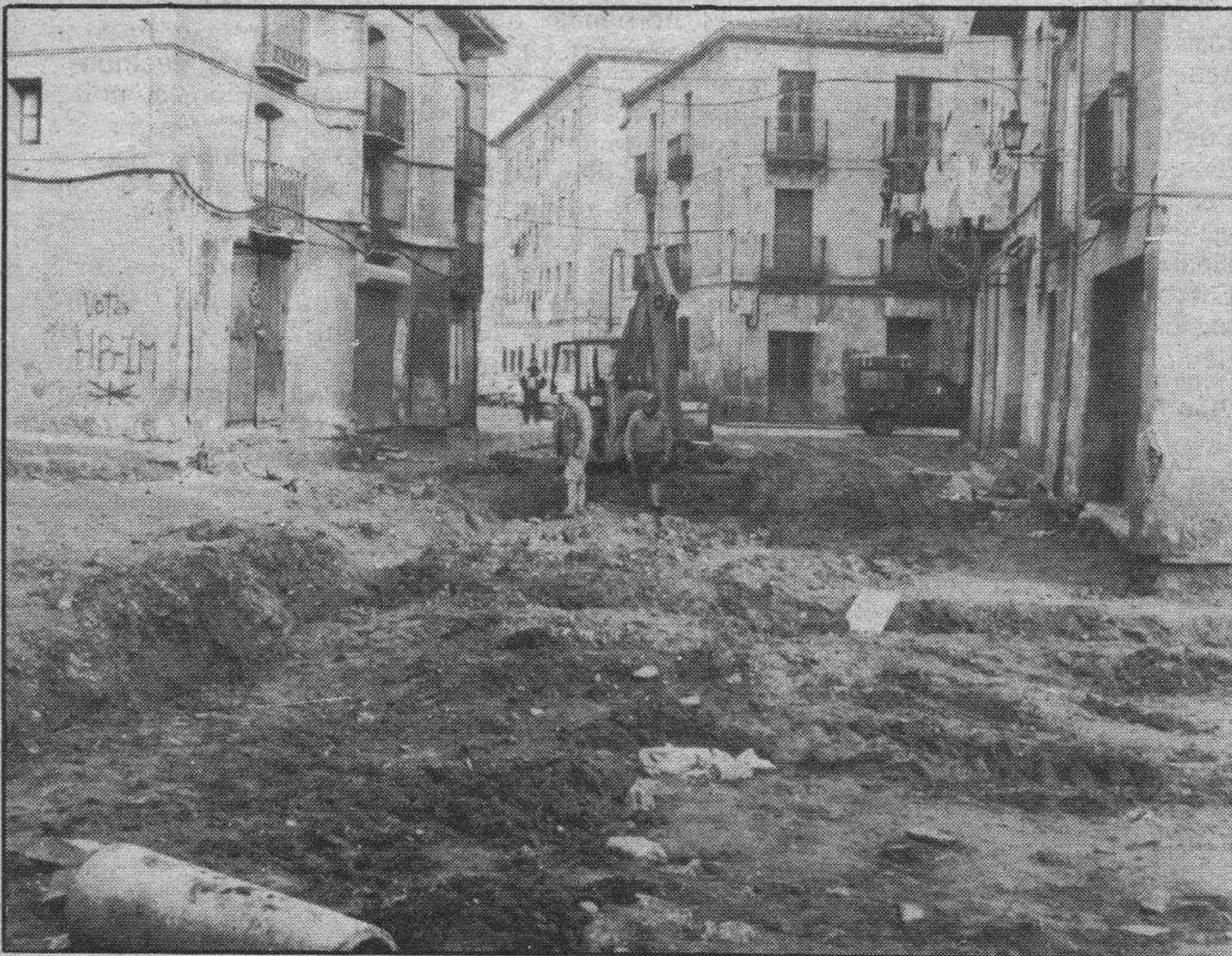
Comienzo de la pavimentación de la Plaza del Mercado. — En la fotografía de Truchuelo, podemos ver la parte central de la vieja Plaza del Mercado, que está siendo dotada de nuevos saneamientos, red de abastecimiento de aguas y acometidas eléctricas. Todo nuevo, como nueva y bonita será su nueva pavimentación en obras que corresponden al plan parcial de urbanización del casco histórico de la ciudad. De momento las molestias para los vecinos son varias, pero todo lo dan por bueno, ante la perspectiva de unos mejores servicios y del embellecimiento de esta vetusta plaza que al igual que el resto de su entorno, pasará a ser peatonal.
