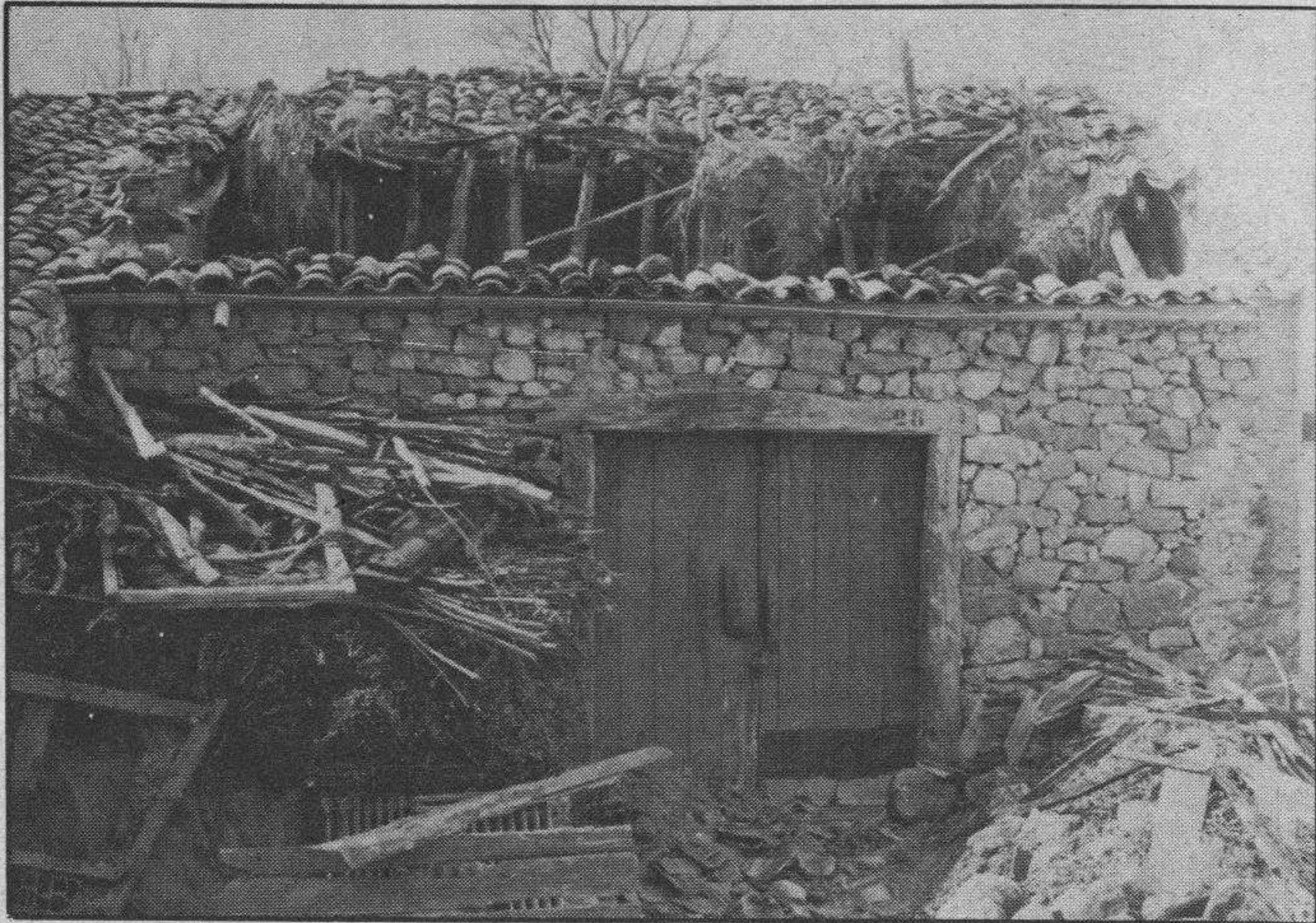
Edificio de Hortigüela, cuyo techo aparece desprendido.
