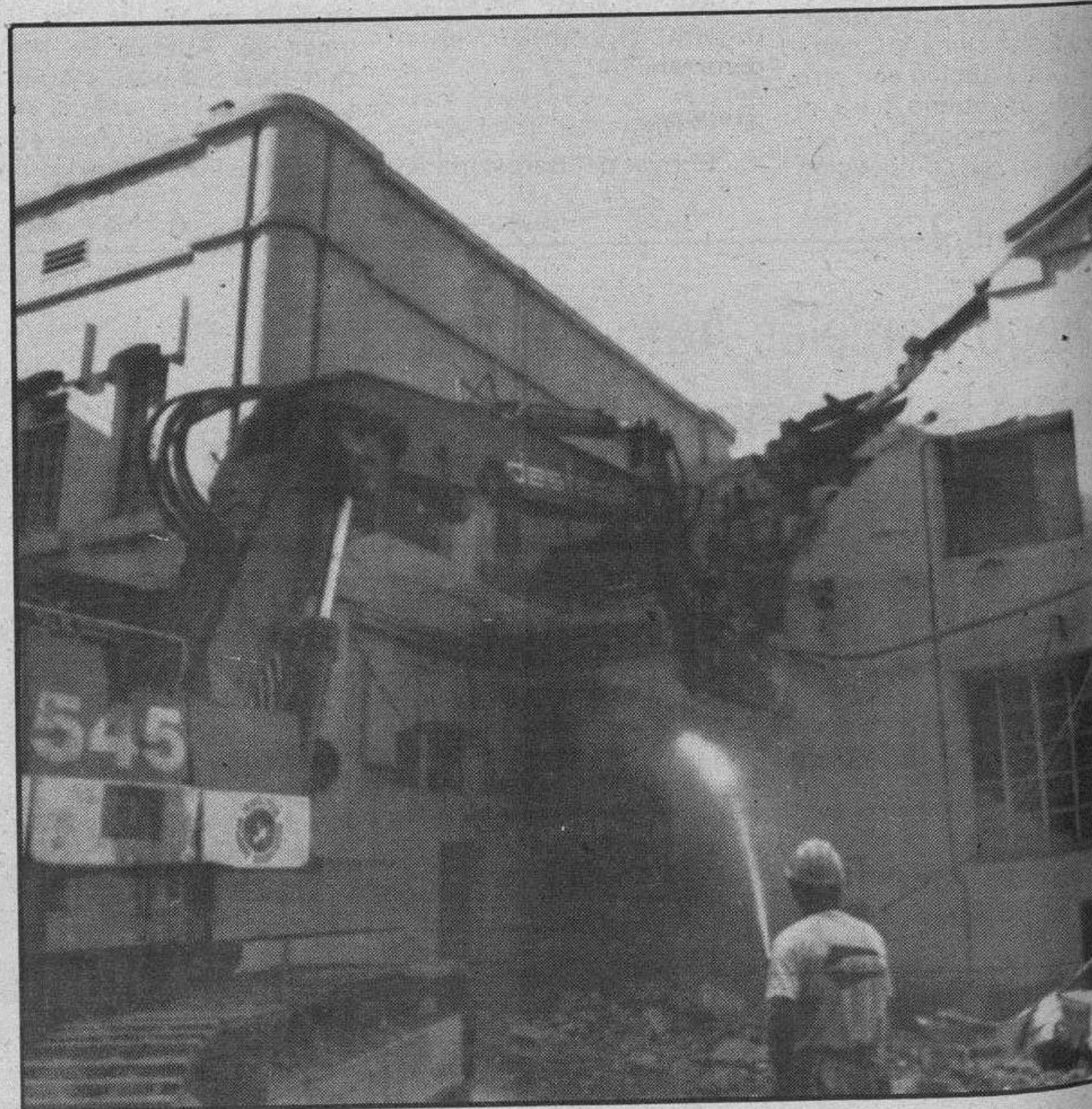
Ayer comenzaron los trabajos de derribo de la factoría de Motor Ibérica. —Foto Efe.
