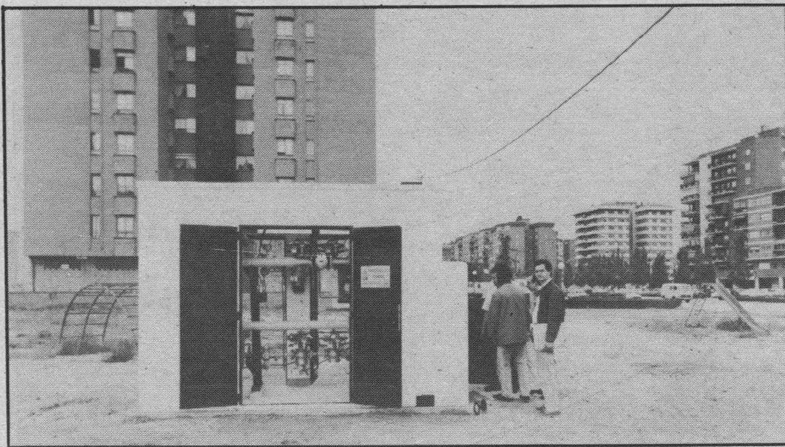
Subestación de gas doméstico. Foto Lara.
