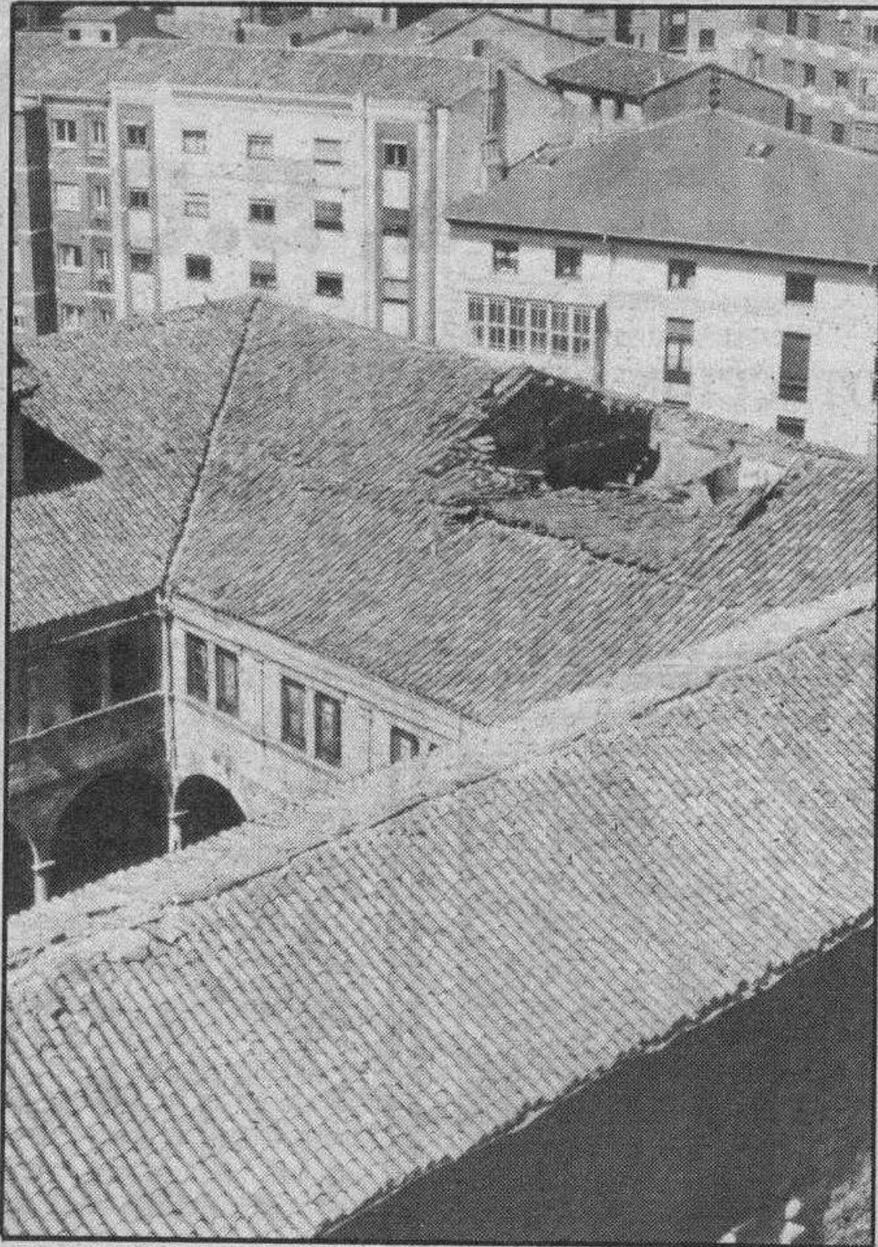
En la parte superior de la foto se puede apreciar el mal estado de la techumbre.
