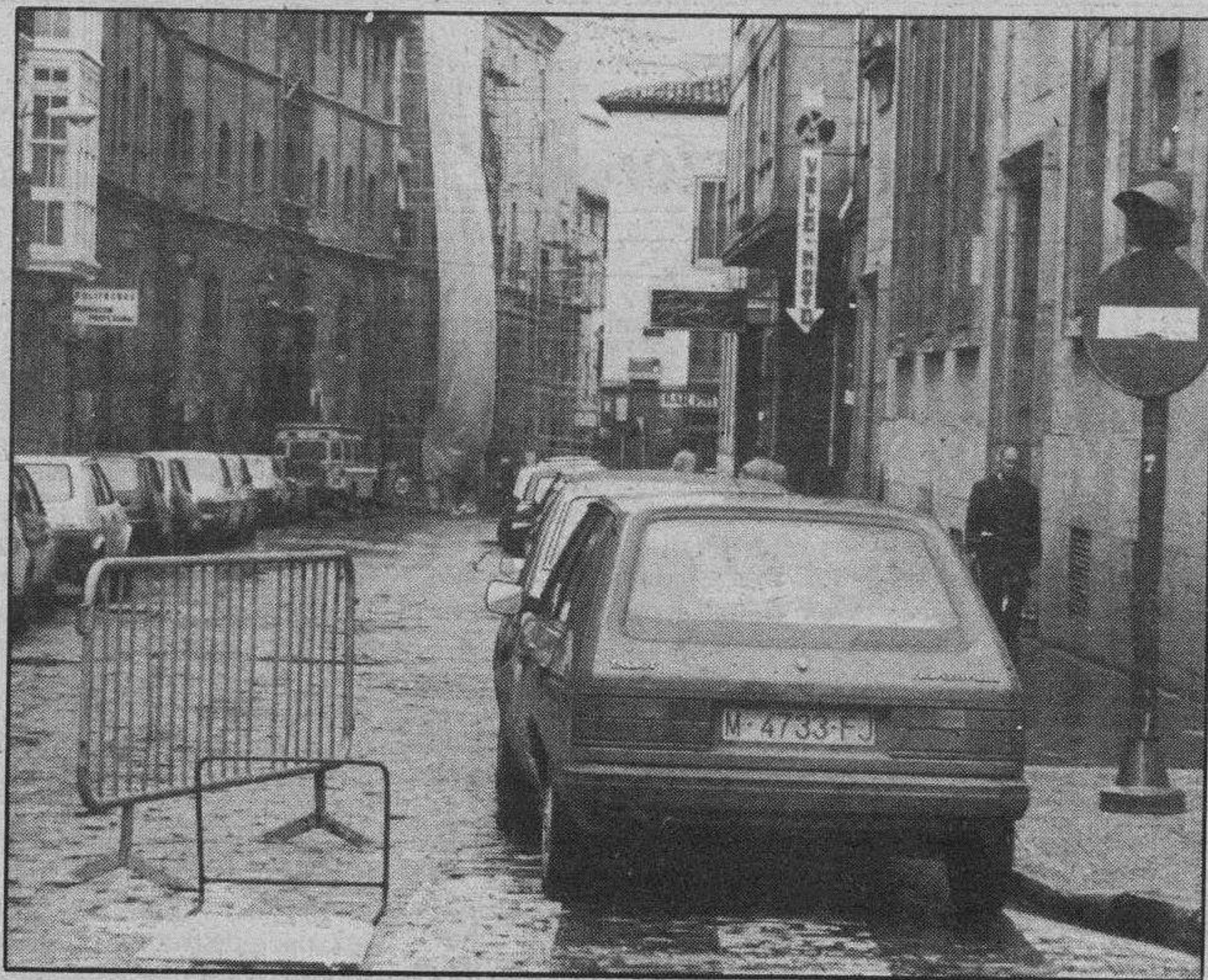
Cortada la calle de La Calera. — Como ya se había anunciado, ayer se cortó al tráfico la calle de La Calera, donde los equipos técnicos municipales van a acometer obras de renovación de la red de alcantarillado y saneamiento. Posteriormente, se llevarán a cabo trabajos para la pavimentación de la misma. La medida estará en vigor hasta que concluyan las obras. No obstante, en la medida en que las circunstancias lo permitan se dará servicio a la mitad de la calle a través de la de Las Trinas.
